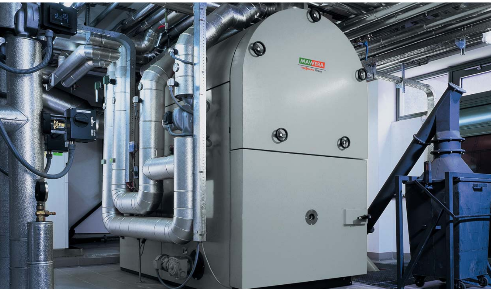
Technologie FU 2500 RA s 2x podsvuným spalováním, Mosser Leimholzbau (výroba lepeného dřeva), Randegg, Rakousko.
